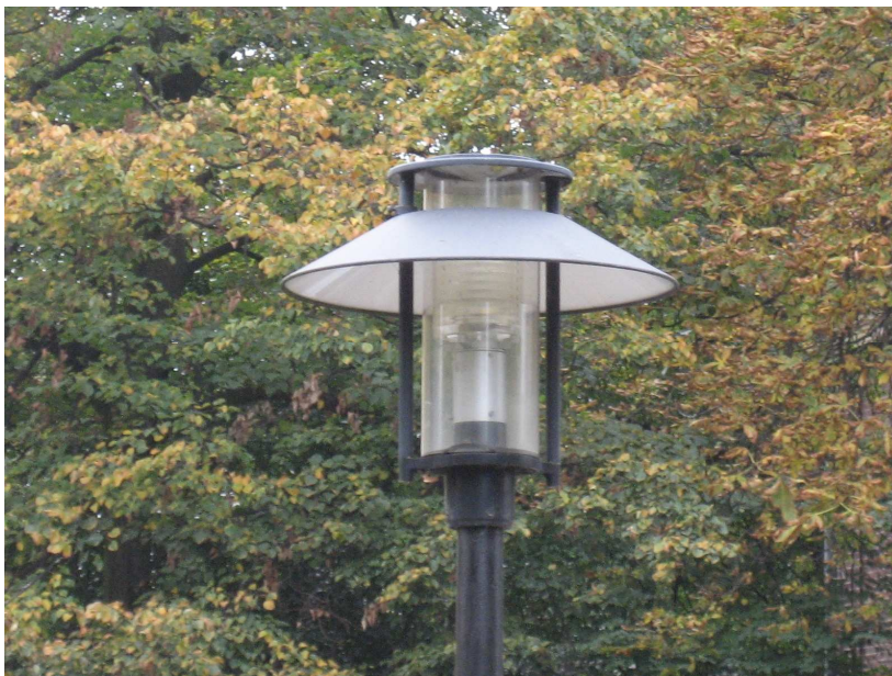
vorhandene Zylinderleuchte mit Dach
