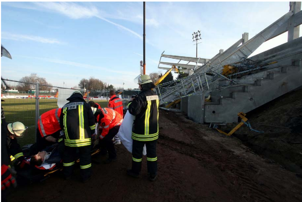
17.01.2009 Während der Bauarbeiten stürzt ein Teil der neuen Tribüne im Preußenstadion ein. Ein verletzter Bauarbeiter wird vom Rettungsdienst der Berufsfeuerwehr versorgt. Foto: MZ, Helmut Etzkorn
