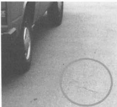
Vor Haus 34 Risse im Belag rechts unten
