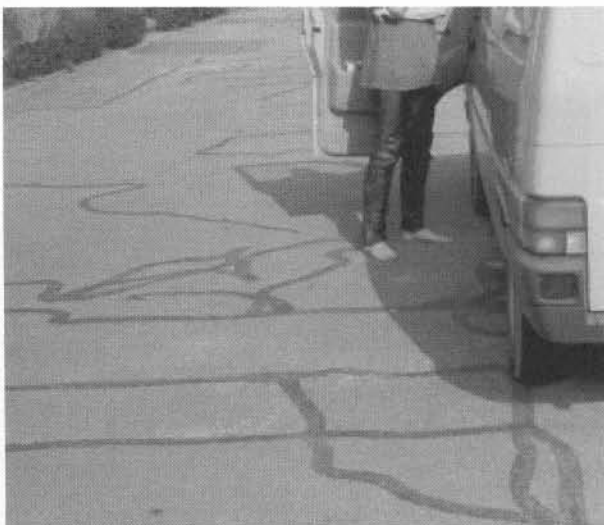
Provisorische Flickstellen vor Haus 34 Bild aus dem Jahr 2002
