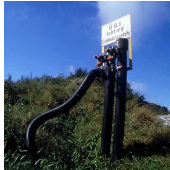
Abbildung 25: Gasfassung der Zentraldeponie II Münster
