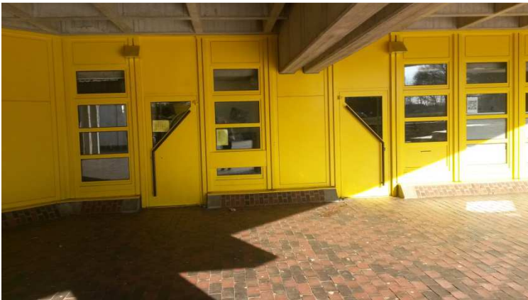
Ostansicht: Schwachstelle Eingangsbereich Sandwichelemente
