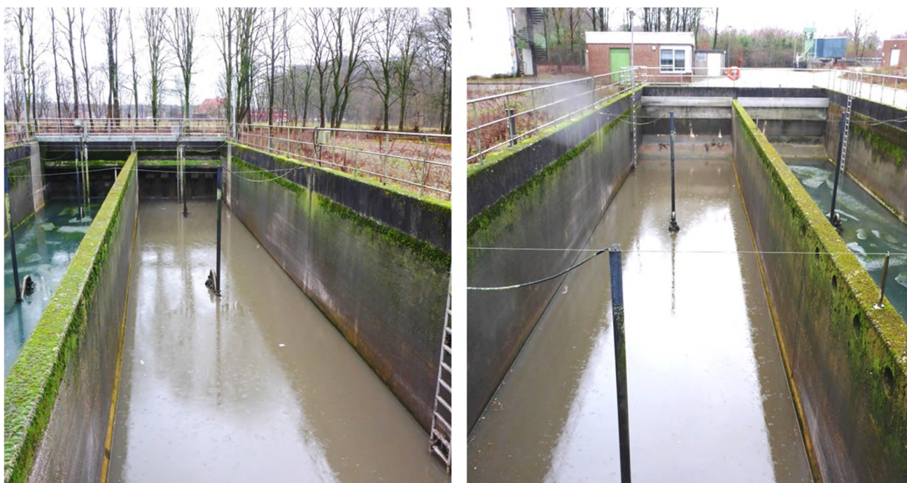
ABBILDUNG 47: REGENÜBERLAUFBECKEN ALBACHTEN STEINBREDE
