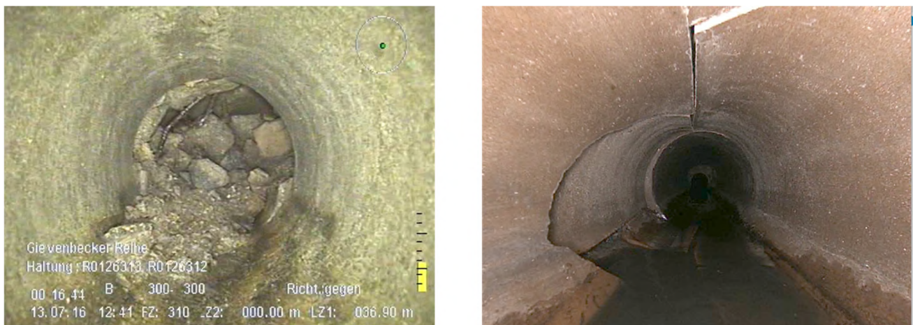
ABBILDUNG 23: SCHADENSbilder EINSTURZ UND ROHRBRUCH (SCHADENSKLASSE 0)
