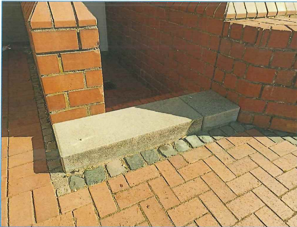
Aufkantung am Kellerabgang
