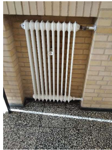
Abbildung 15 Heizkörper Klassentrakt mit Nische
