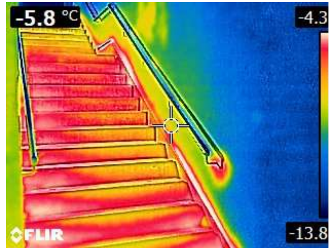
Abbildung 4 Wärmebrücke Stb.-Treppe, Geländer
