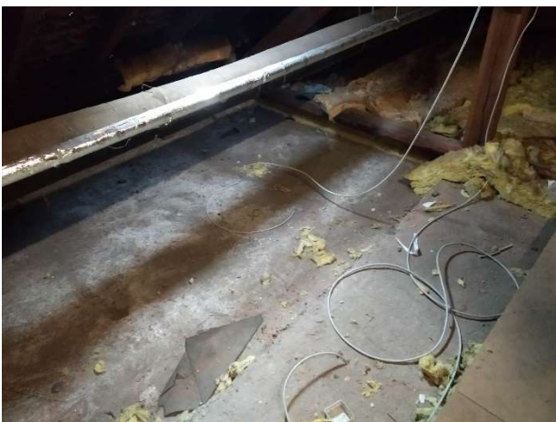
Abbildung 4 Oberste Geschossdecke, Dämmung aufgrund von Wasserschaden entfernt
