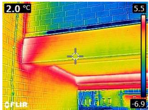
Abbildung 9 Turnhalle/Hausmeisterwohnung, Wärmebrücke Stahlbetonbalken
