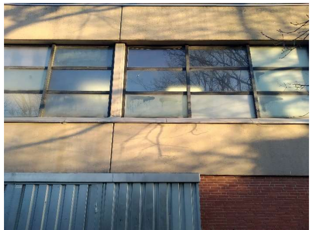
Abbildung 12 Tauwasserausfall an Fenstern
