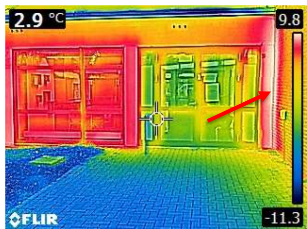
Abbildung 5 Geometrische Wärmebrücke, geringe Dämmschicht, unterschiedliche thermische Qualität Tür/Fensterbereich
