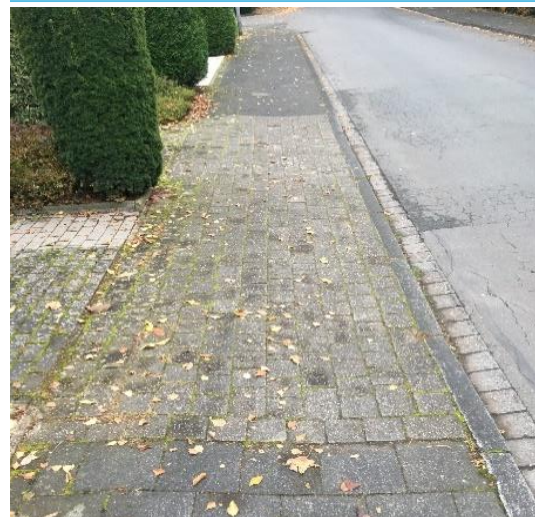
Abbildung 8: Querneigung und Gehwegabsenkung in der Dorffeldstraße in Roxel
