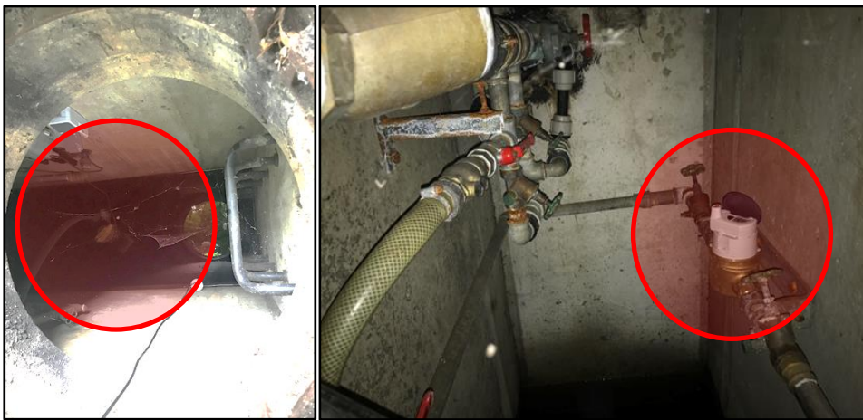
Abb. 36 + 37 Einstieg Installationsschacht mit Hebeanlage | Trinkwasserinstallation
