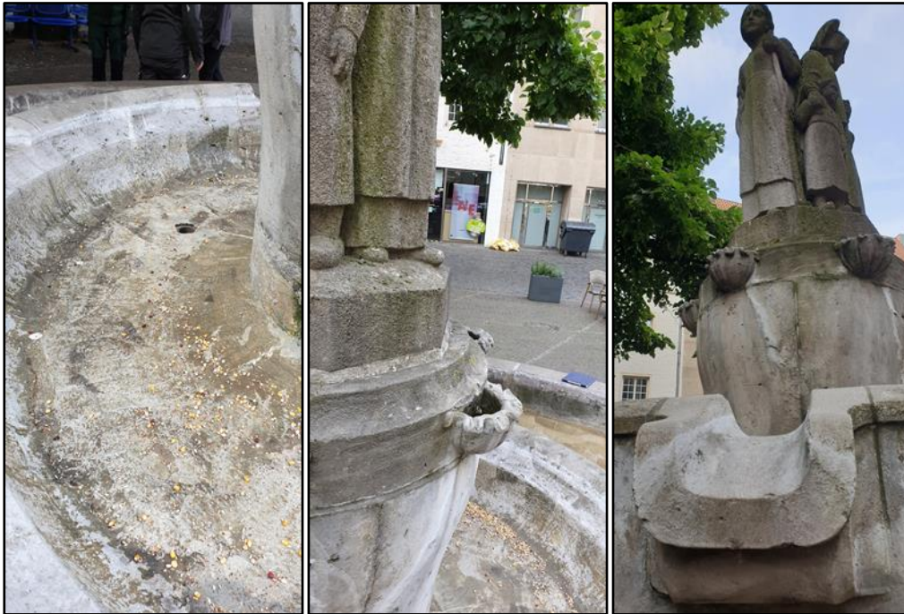
Abb. 9 + 10 + 11 Ablauf obere Brunnenschale | Auslauf Skulptur | Auslauf obere Brunnenschale
