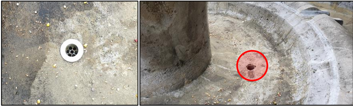
Abb. 16 + 17 Auslauf (früher Quellsprudler) unteres Brunnenbecken_gesamt 6 Stück | Ablauf obere Brunnenschale
