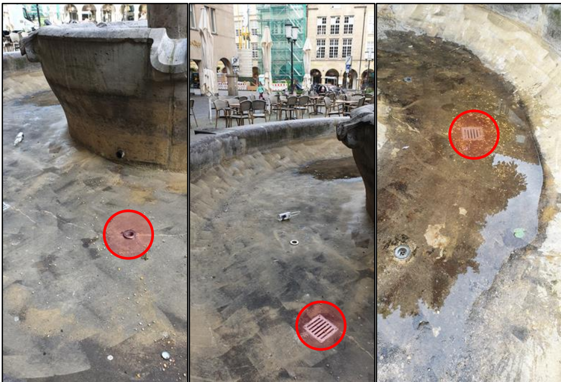
Abb. 18 + 19 + 20 6 Stück Auslauf (früher Quellsprudler) unteres Brunnenbecken | 2 Stück Ablaufroste- Ablaufleitung unteres Brunnenbecken- verstopfter Ablauf
