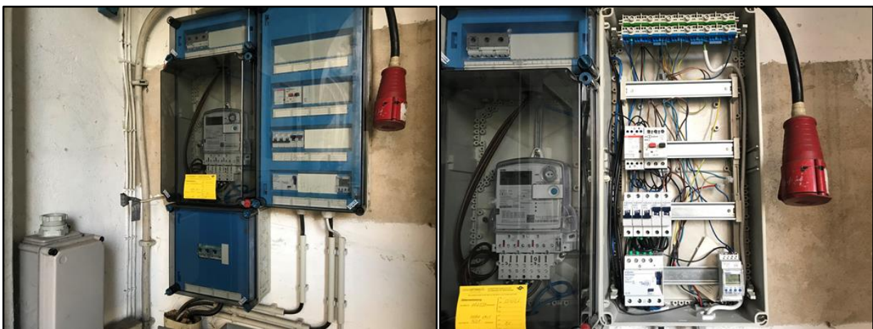
Abb. 51 +52 Schalt- und Steueranlage
