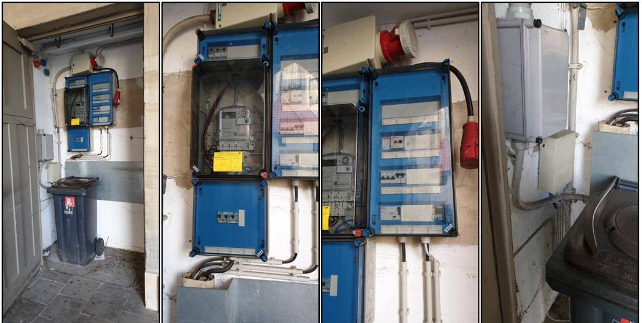
Abb. 47 +48 +49+ 50 Hausanschluss und Zählereinrichtung | Schalt- und Steueranlage
