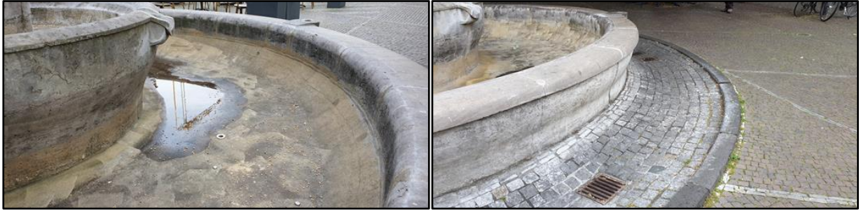
Abb. 23 +24 Oberflächen Brunnenbecken unten | umlaufende Rücklaufrinne als Pflasterinne mit Kleinpflaster und Rücklaufschächte mit Straßenabläufen
