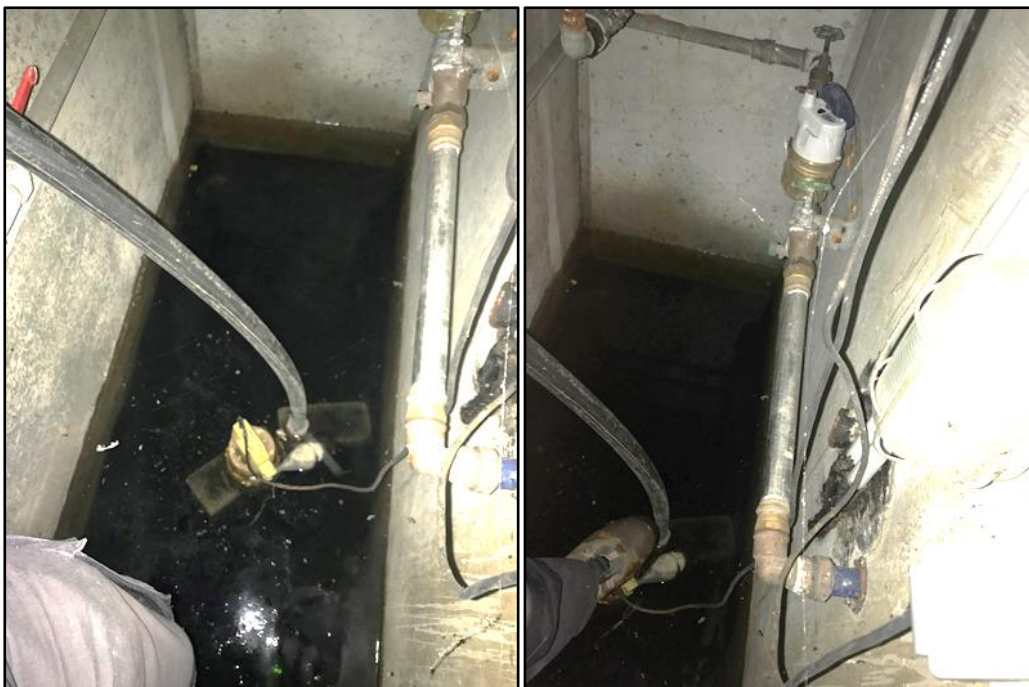
Abb. 38 + 39 Hebeanlage mit Abwasserdruckrohrleitung | Trinkwasserinstallation Wasserzähler
