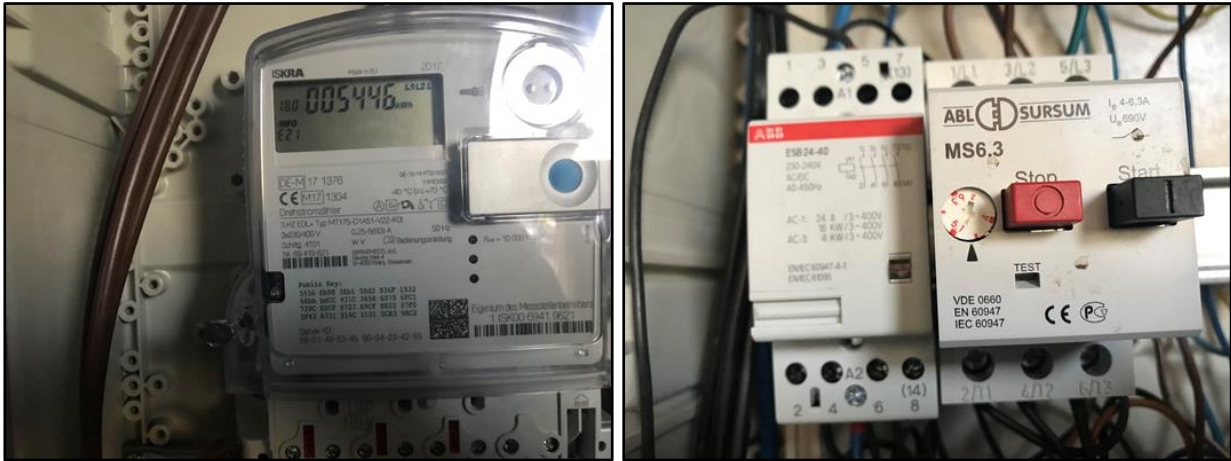
Abb. 53+ 54 Neuer digitaler Zähler | ABB 4-poliger Installationsschutz und ABL Motorschutzschalter
