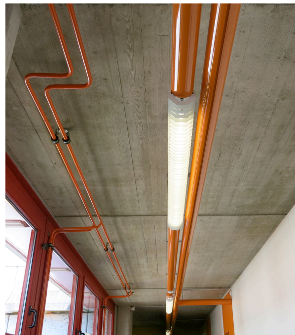
Versorgungsleitungen im Farbleitsystem
