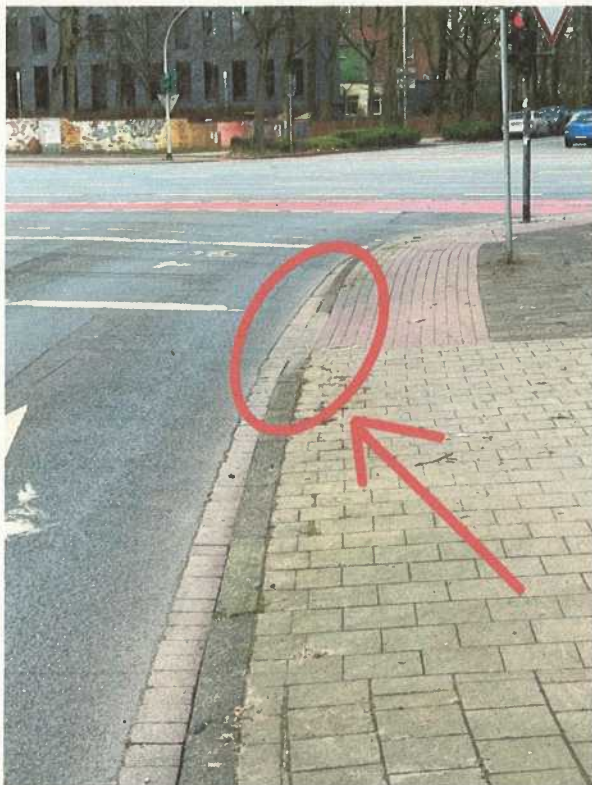
(a) Abgesenkter Bordstein vor Haltelinie
