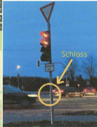
(b) Ampel mit Steuerungszugang
