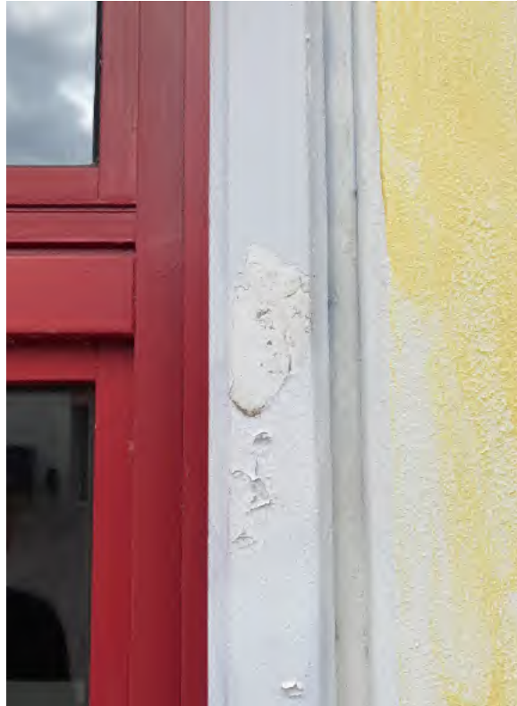
Abb. 23 Schadhafter nicht bauzeitlicher Schutzanstrich und darunter liegende bauzeitliche Sichtbetonoberfläche
