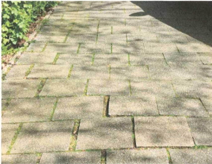
Abbildung 2: Gehwegschäden vor der Sanierung (breiten Fugen und unebene Oberfläche)
